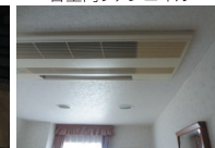
客室内ファンコイル
